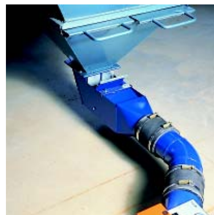
En separator används vid sugning av material från silo
